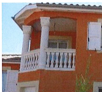
Type de balustres interdites
